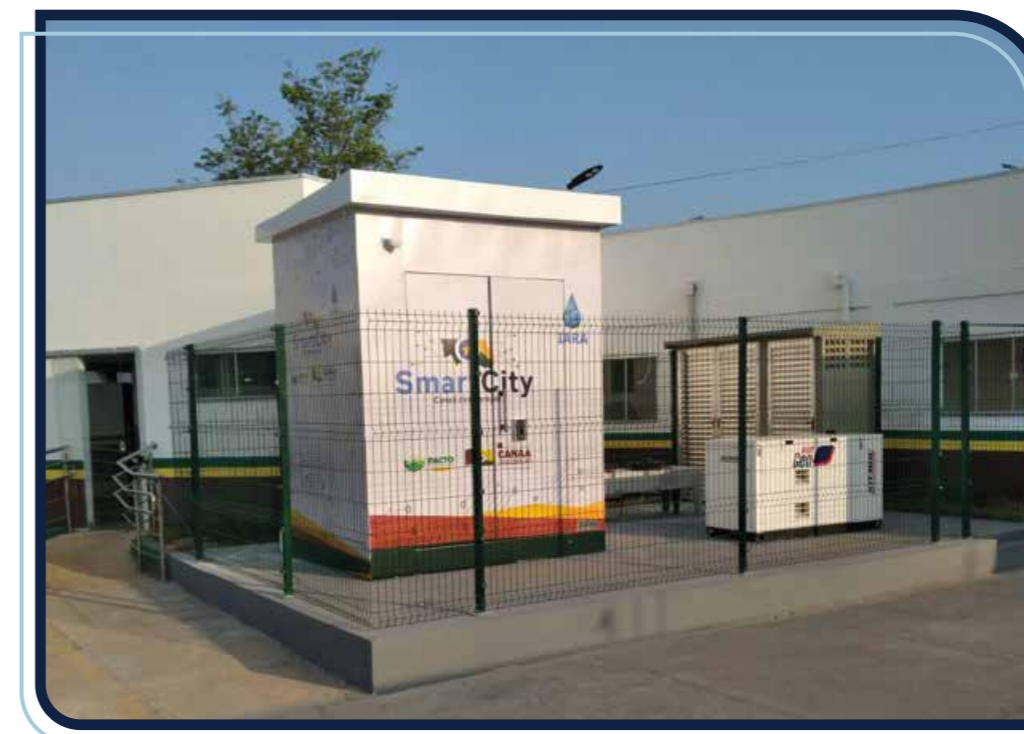
Figura 3.2 Solução de Micro Data Center da Cidade Inteligente de Canaã dos Carajás
