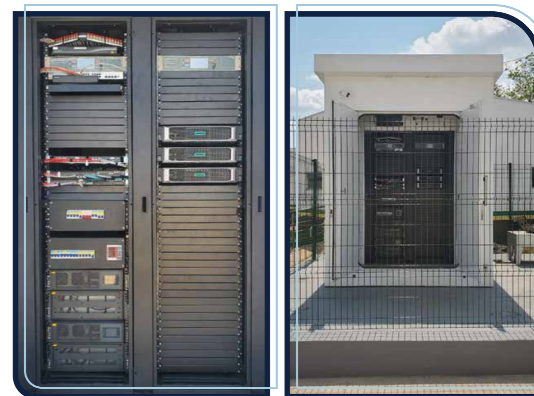
Figura 3.3 Visão interna da solução de Micro Data Center
